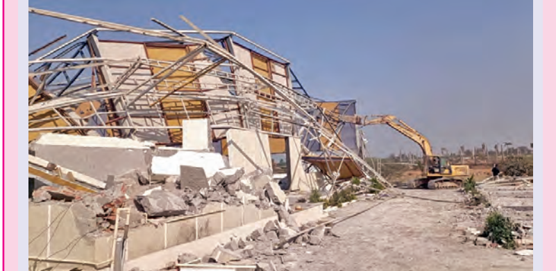
దేవరయాంజాల్ కోమటికుంటలో అక్రమ నిర్మాణాలను కూల్చివేసిన హైద్రా అధికారులు
